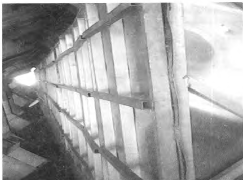
图 4 电解槽使用的保温型槽盖板 Fig.4 Insulation type groove cover for the use of electrolytic cell
